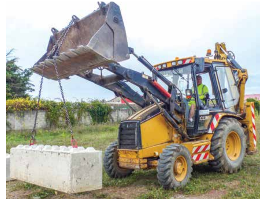
Il faut aussi déplacer les blocs pour intervenir sur le complexe. Le montage (et démontage) des scènes pour l'accueil des nombreuses manifestations occupe aussi une part importante du travail.
