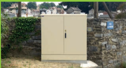
Armoire de raccordement du cimetière du village
